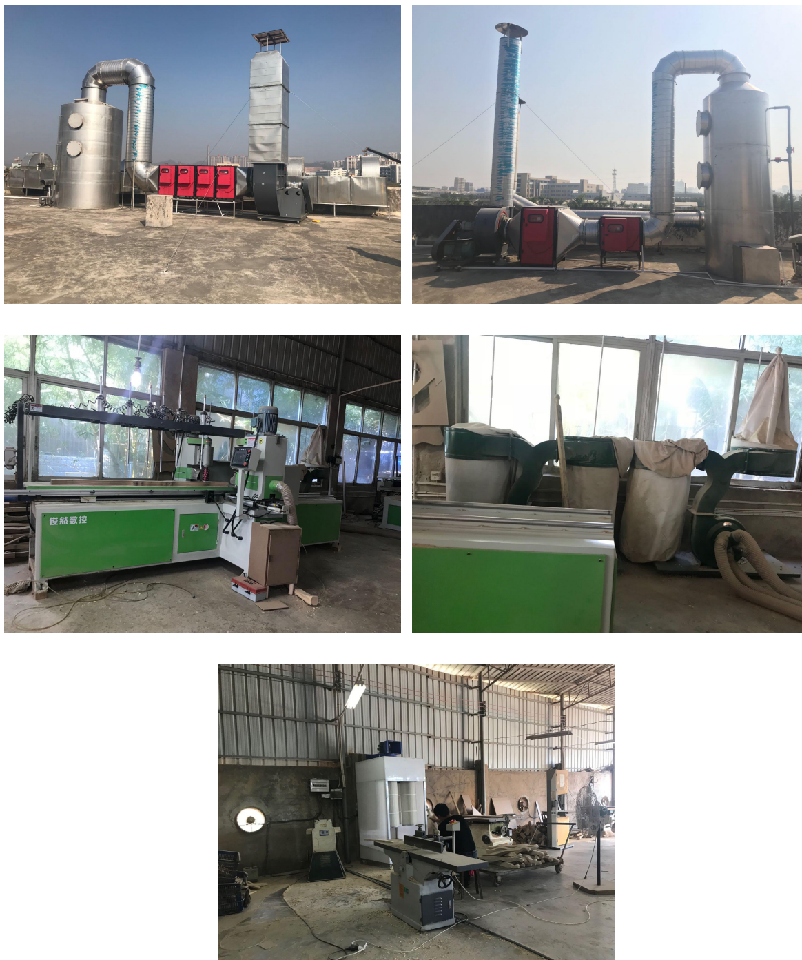
图 6 生产车间废气治理设施
