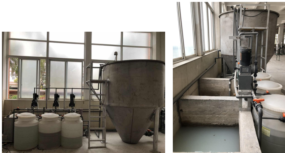
图 5 生产车间废水治理设施
